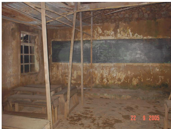
Estado de las aulas en la visita que realizamos a Angumu
